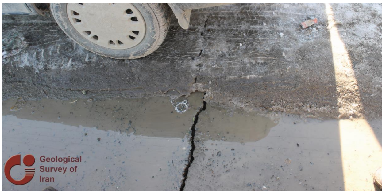
گسیختگی سطحی در سطح خیابان روستای گرناویک.
