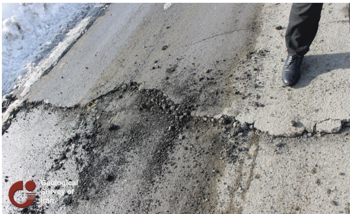
گسیختگی در سطح آسفالت جاده گرناویک-میرعومر در امتداد NE-SW.
