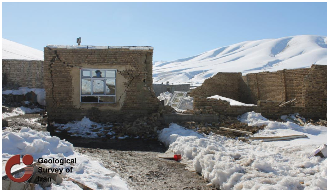
تخریب سازه آجری در روستای میرعومر.
