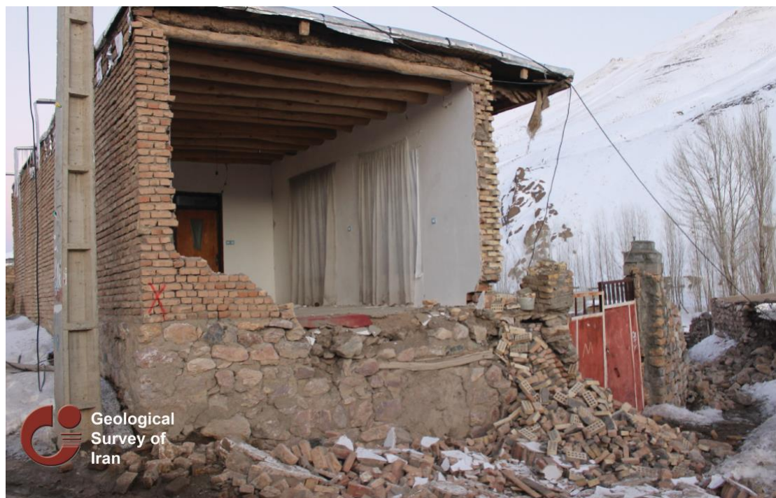
تخریب سازه آجری در روستای راویان.
